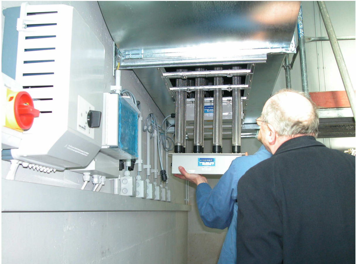
ARA Murten, Hebewerk, Raumgrösse: 1040 m 3 , Luftmenge: 8000 m 3 /h
